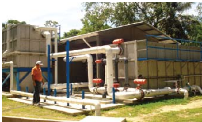
Planta potabilizadora en el sistema Piedras Gordas.
