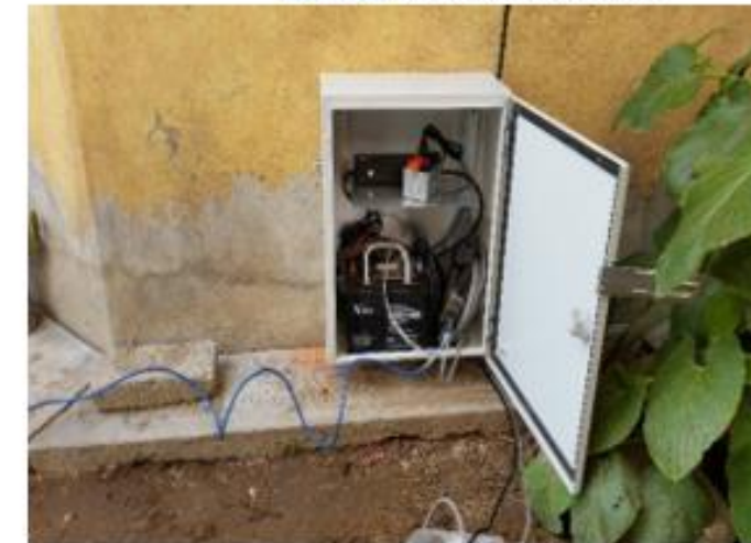
d) Resguardo de batería, interruptor, cables, chapa y candado
