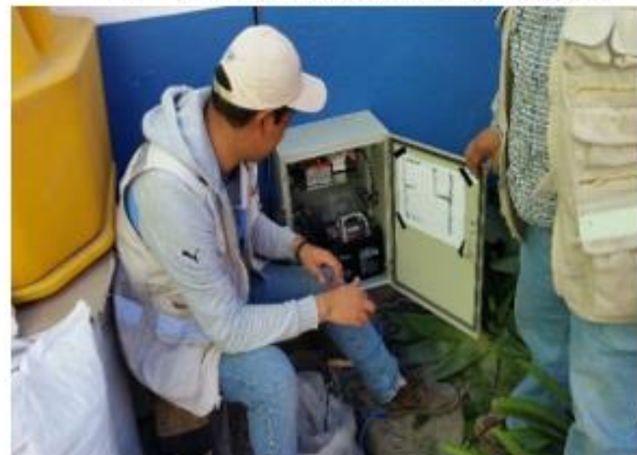
c) Caja metálica de resguardo
